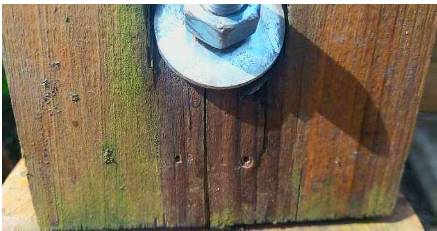
Příklad degradace konstrukčního dřeva hnědou hnilobou způsobená dřevokaznou houbou
